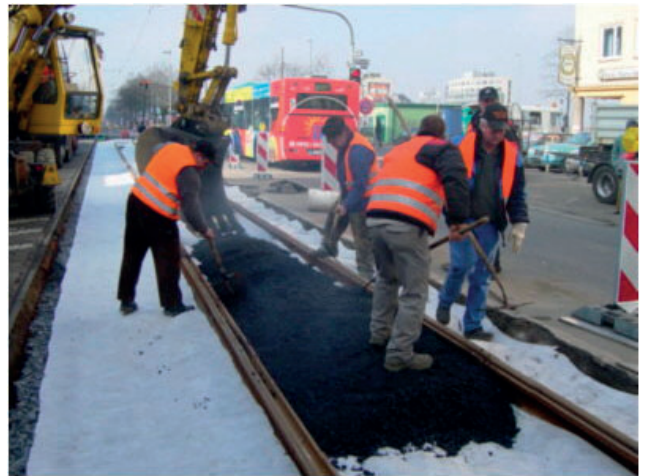
Frankfurt am Main: AC 32 T S 30/45, temperaturreduziert im Handeinbau bei 3 °C Außentemperatur
